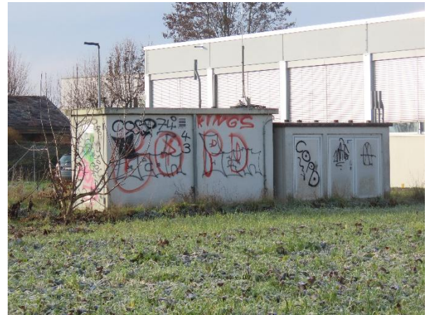
Abb. 11: Erdgasdruckregelanlage im Westen auf Flst.-Nr. 2437
